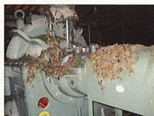
津波によるポンプの被水状況
