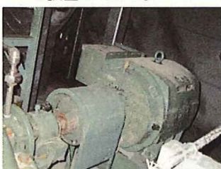
津波によるモータの被水状況
