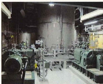
1号機ほう酸水注入系のタンクとポンプ
