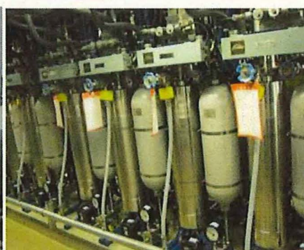
1号機水圧制御ユニット
