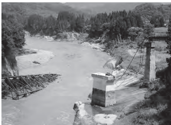
流出した第七只見川橋りょう（金山町）
