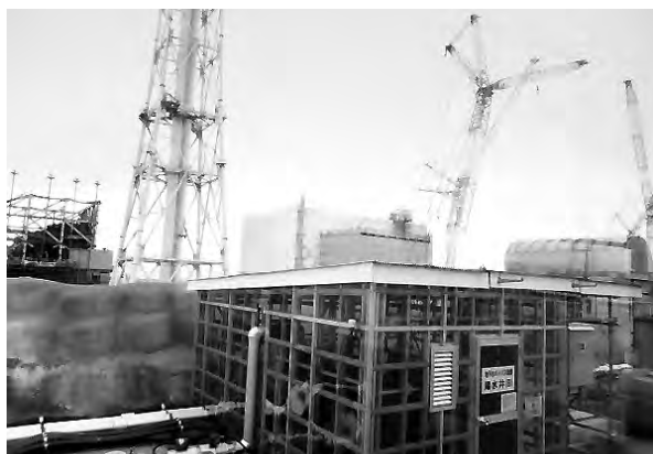
(写真は高台からのもので、手前は地下水バイパス井戸、奥は1～3号機建屋です)
