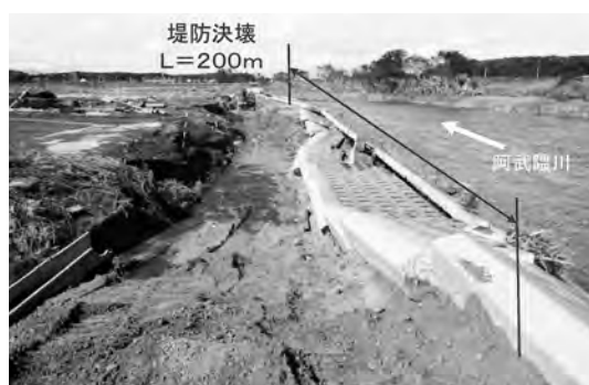
図14 矢吹町明新東地先の破堤状況 (10/13撮影)
