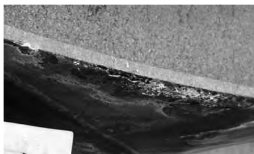
写真-2 耐候性鋼材の腐食
