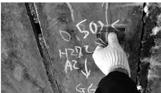
写真-4 プレテンション桁のひび割れ
