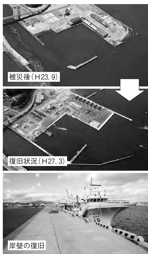
写真3 松川浦漁港の被災と復旧
