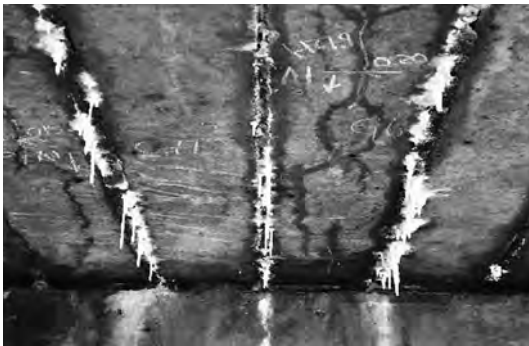
写真-3 間詰め床版のエフロレッセンス
