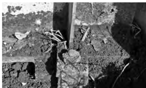
写真-1 桁端部の腐食
