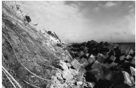
写真－3 被災状況（金ヶ沢南地区）
