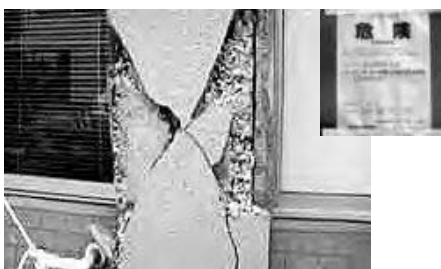
合同庁舎北分庁舎の柱の座屈
