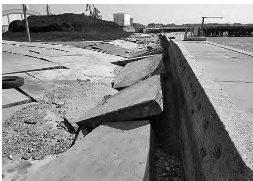
(5号埠頭先端護岸被災状況)
