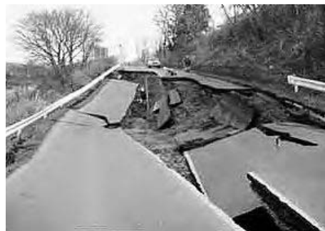
県道磐梯熱海停車場線の崩落状況
