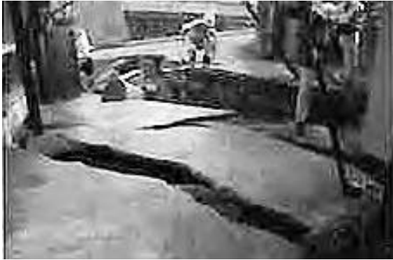
緩い締め固め状態の盛り土の被害実態
